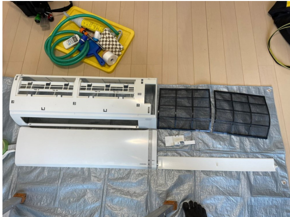
17.エアコンクリーニング
